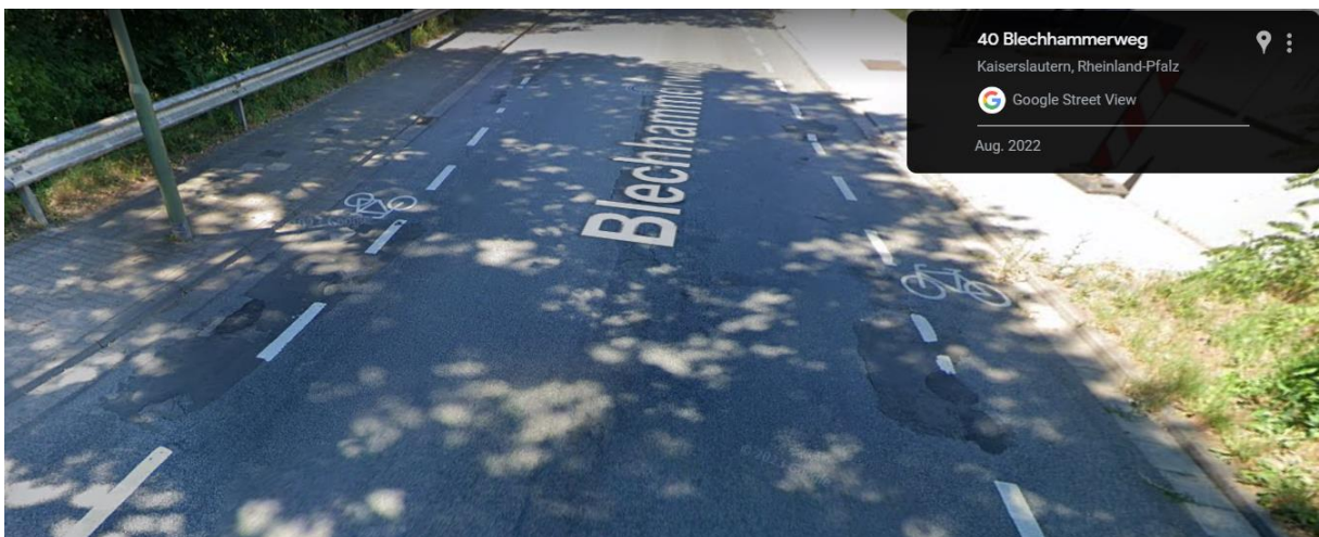
Abbildung 47: Blechhammerweg auf Höhe der Kreuzung Danziger Straße (Google Street View). Unebenheiten und Flicker auf dem Schutzstreifen.
